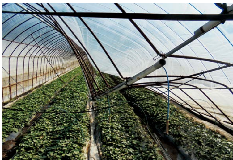
▲春先の突風でパイプが曲がったハウス
